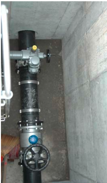
Bild 3: Die bereits fertiggestellte Dotiereinrichtung von Leimboden.
